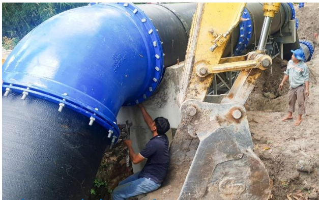
Lắp đặt tuyến ống chuyên tải D1200 từ ranh Bình Dương đến thị xã Bình Long tỉnh Bình Phước
